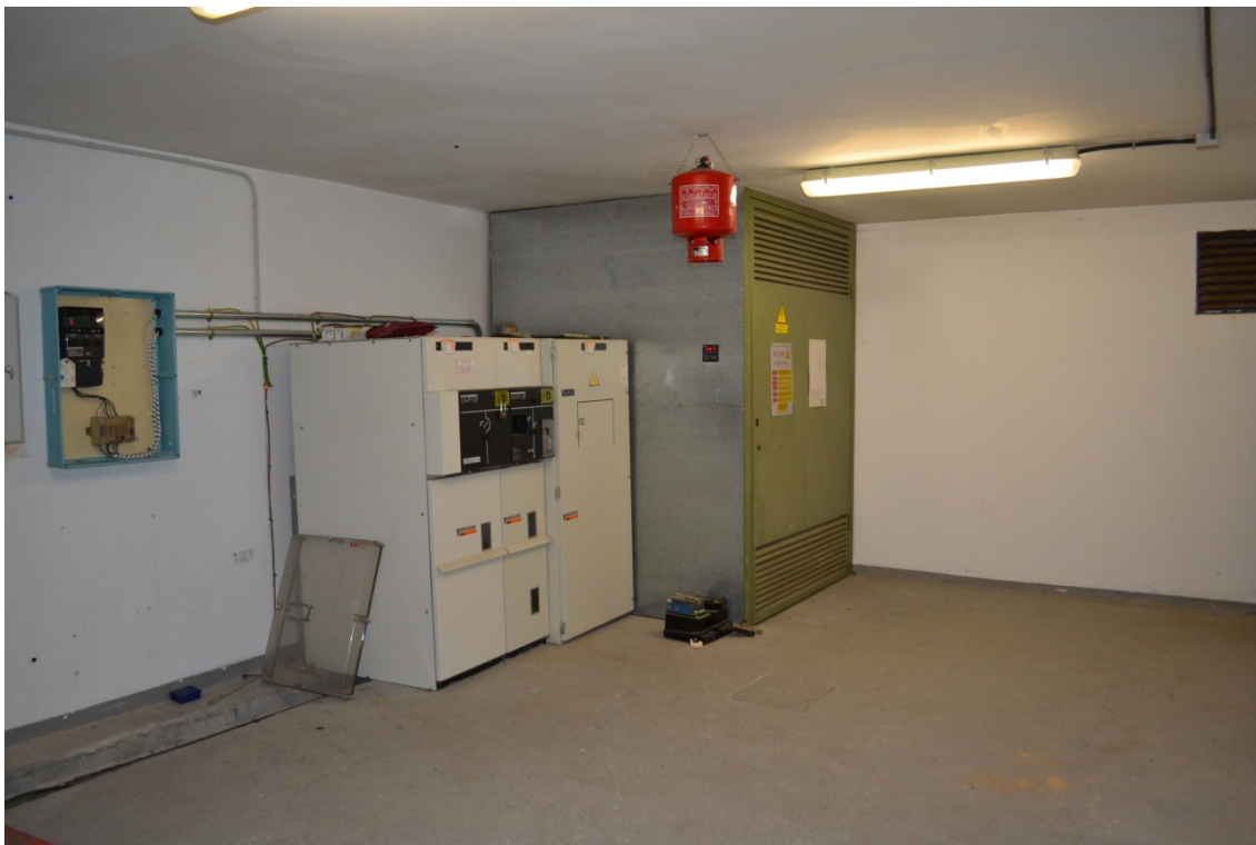
Cuarto eléctrico con centro de transformación y cuadros generales
