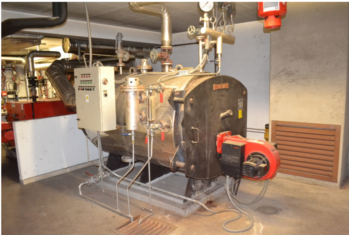
Caldera de vapor de la sala de calderas
