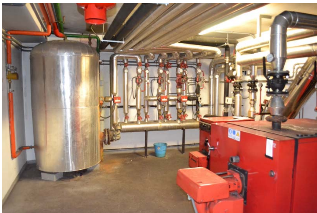
Sala de calderas, detalles de depósito de a.c.s.
