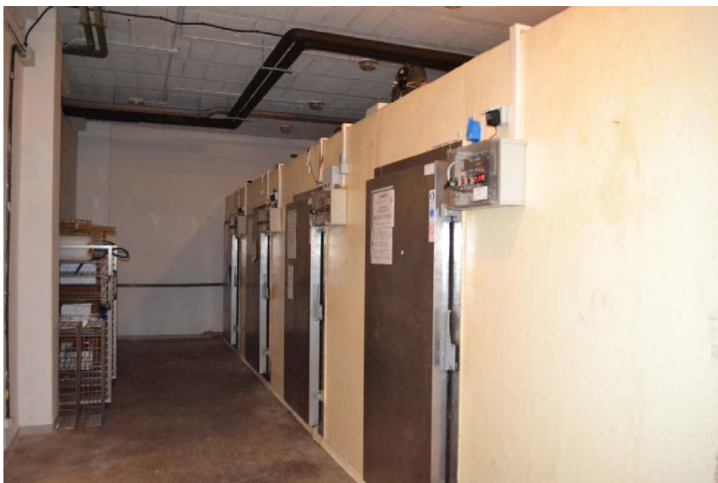
Cámaras de planta piloto
