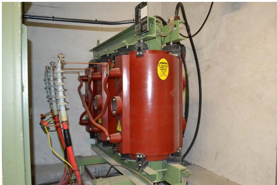
Detalle de transformador
