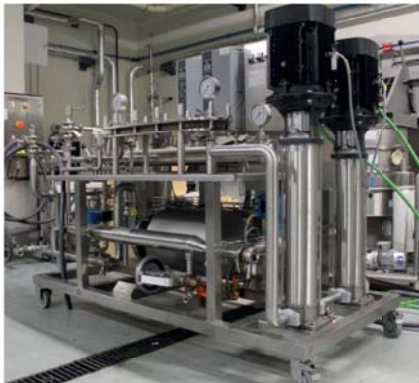
Sistema de filtración con membranas
