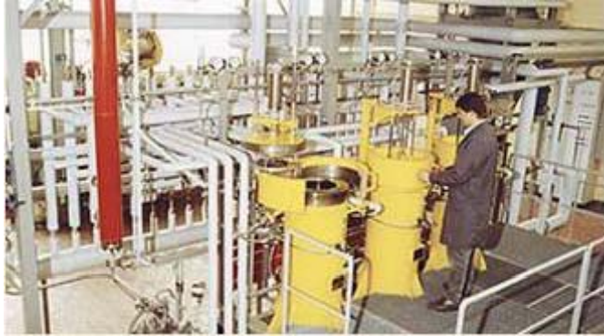
Vista general de la planta de extracción
