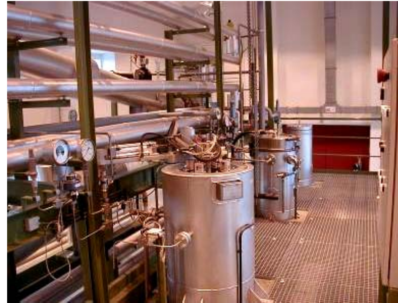
Planta de extracción multiproducto situada en la República Checa.
